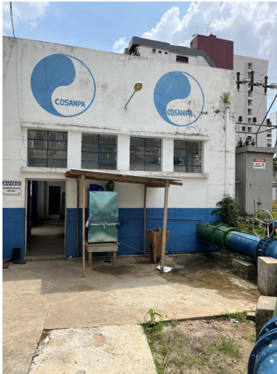
Figura 3 – Vista externa da sala de bombas do terceiro setor de abastecimento de água
