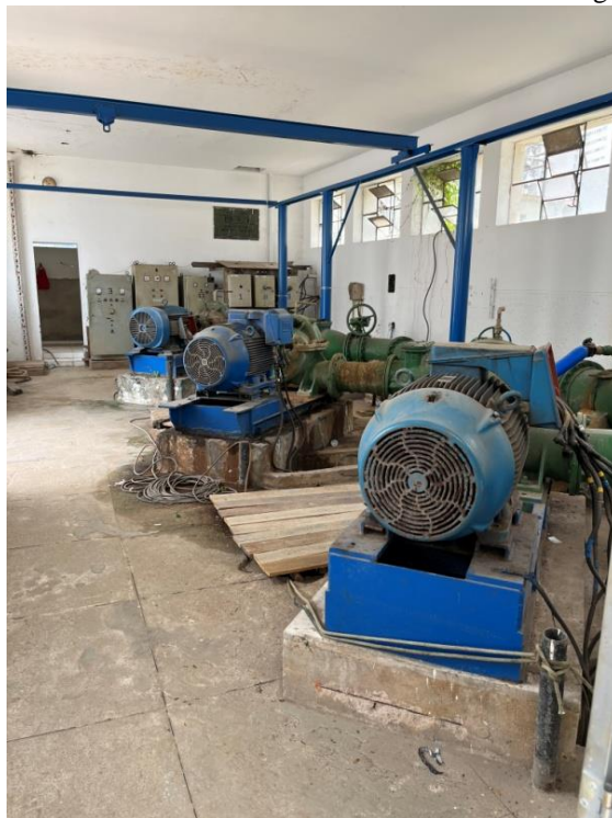
Figura 4 – Sala de bombas do terceiro setor de abastecimento de água da COSANPA
