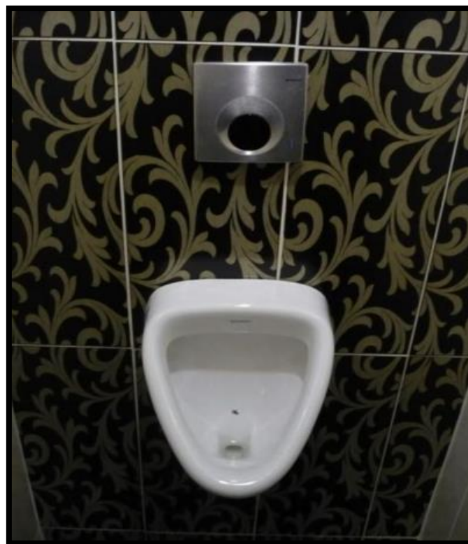
Figura 1 – Banheiro tem mosca no mictório
