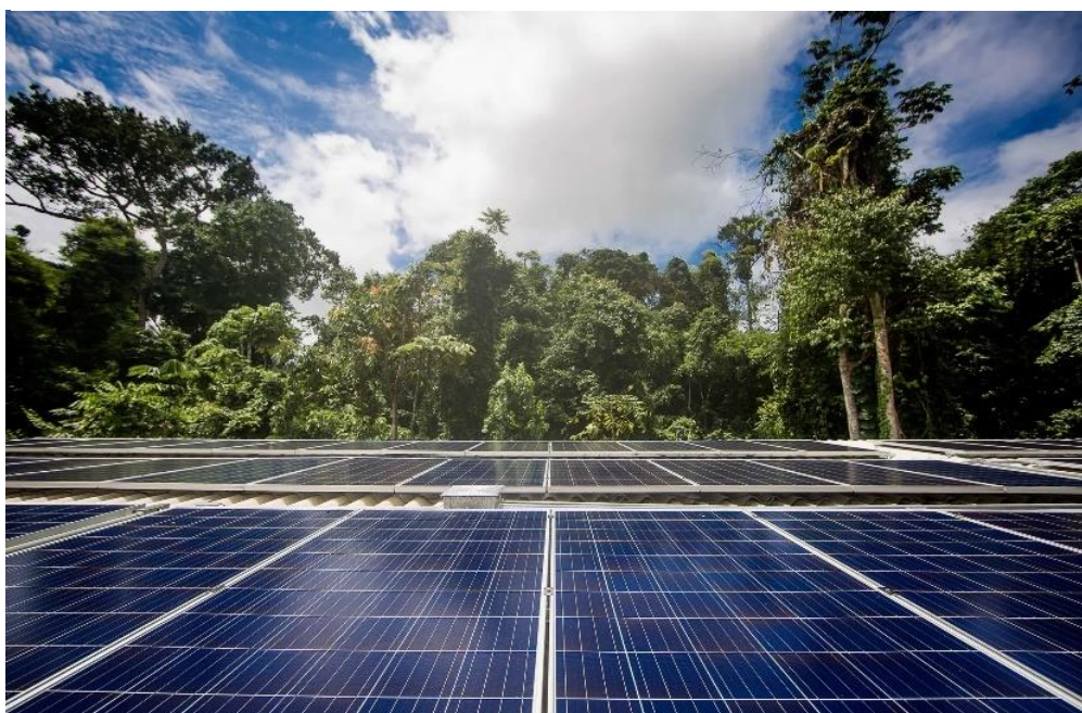
Figura 14: Sistema de placas solares do Cristalino Lodge.
