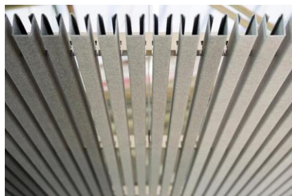
Figura 38-Detalhe do forro modular acústico
