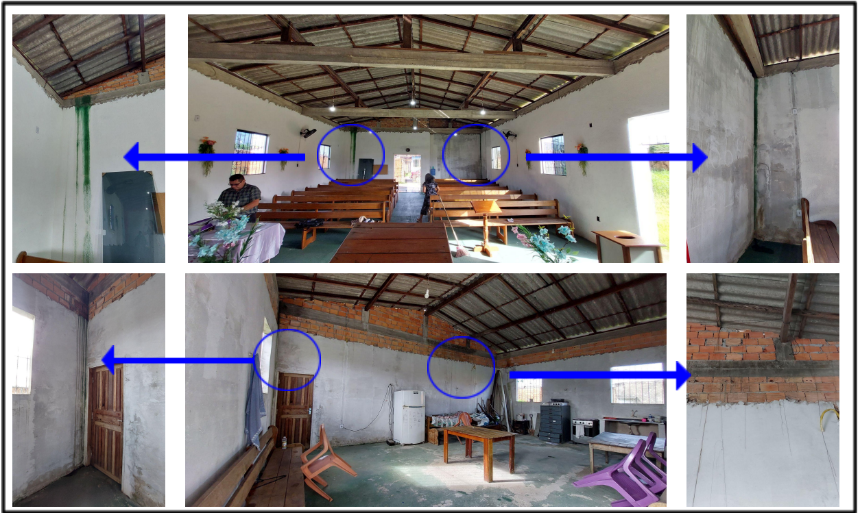
Figura 28: destaca os pontos de infiltração na igreja e na sala anexa
