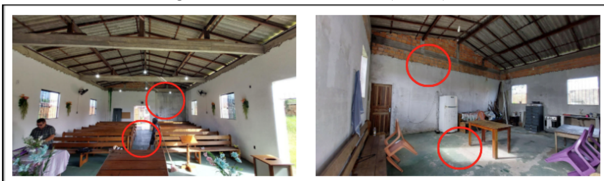
Figura 30: mostra a falta de acabamentos (vermelho)
