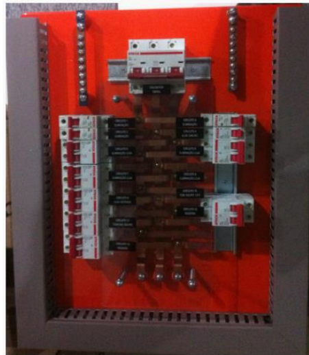
Figura 13 – Quadro de distribuição elétrica
