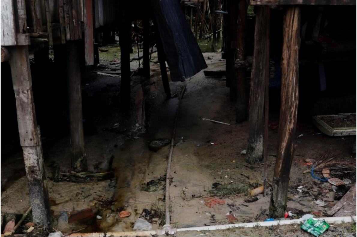
Figura 9 – Lixo e tubulações expostas entre vigas de palafitas em área de mangue no Camambá
