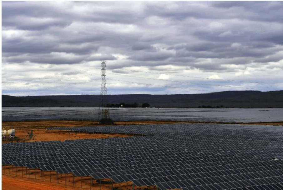
Figura 25 - Usina solar em Minas Gerais.
